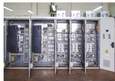
Quadro di automazione linea produzione
